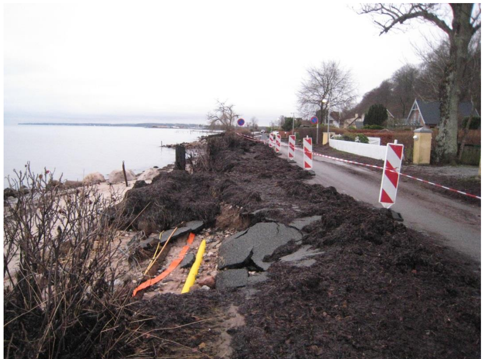
Figur 1.1: Erosion af Gl. Strandvej under stormen Bodil 5-6. december 2013. Det gule rør viser en gasledning og det orange kabel viser el-ledning, der var eksponeret for bølgepåvirkning under stormen.
